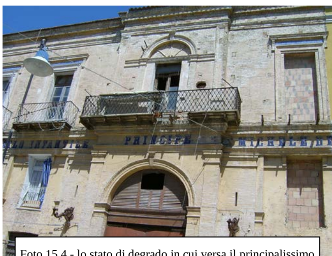
Foto 15.4 - lo stato di degrado in cui versa il principalissimo palazzo che ospitava l'asilo "De Sangro"
