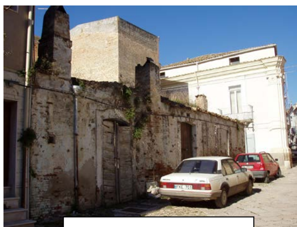
Foto 17.4 - una costruzione fatiscente nei pressi di Via N. Fiani
